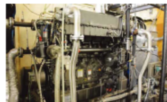
ガスエンジン試験設備
