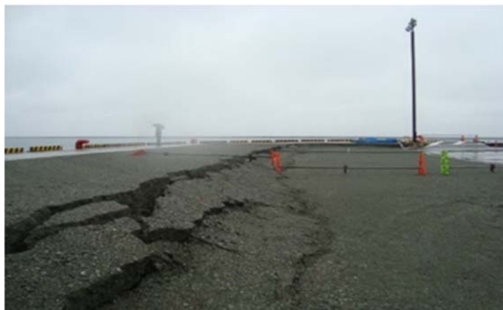
図 1.5.1 福島県沖地震による相馬港の被害
