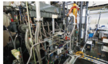
ガスエンジン
