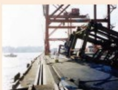
兵庫県南部地震の被害
