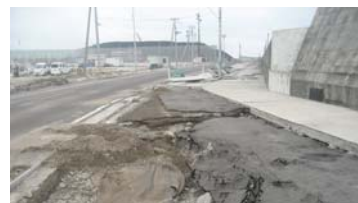
越波で破壊された護岸
