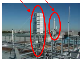
アンテナの外観
